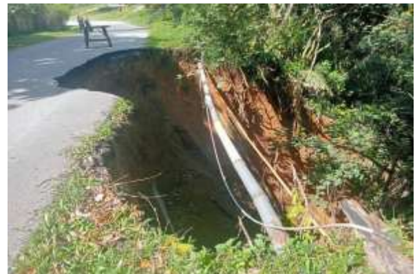
Gambar 3. Kondisi tanah longsor pada tahap survey
