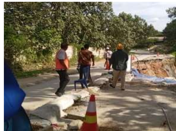
Gambar 4: Kondisi longsor pada tahap investigasi geoteknik
